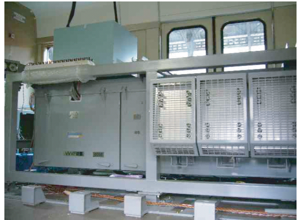
図3 燃料電池用高圧インバータ装置
