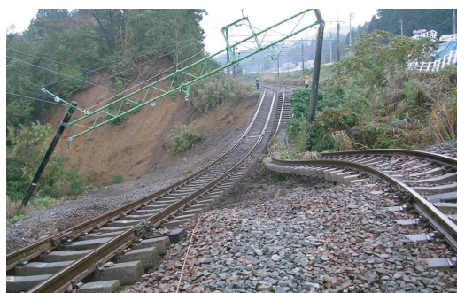
図2 上越線221km000m付近盛土崩壊状況
