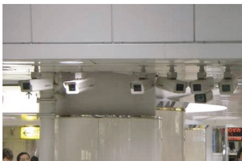
図1 駅構内に設置された監視カメラ
