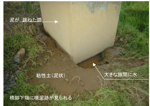
図1 高架橋柱の噴泥痕跡
