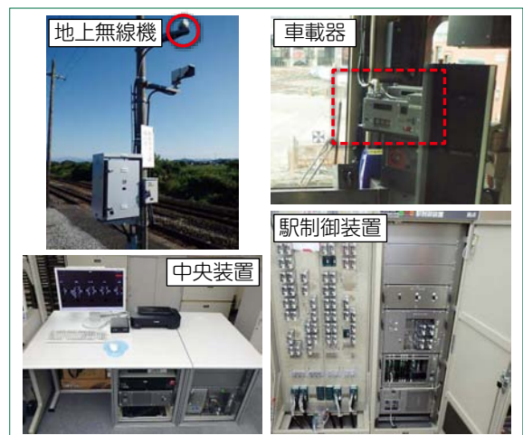
図2 境線システム 各装置
