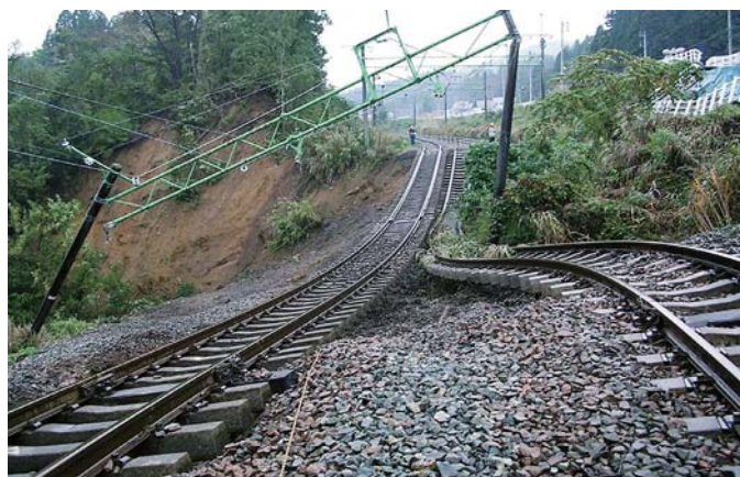
図1 盛土の地震による被災状況
