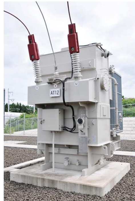
図3 単巻変圧器(新幹線用)の外観
