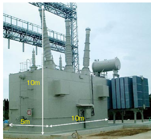
図3 ルーフ・デルタ結線変圧器の外観（新七戸変電所）
