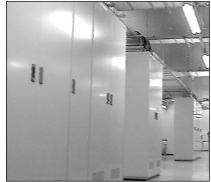
図3 電子連動装置の外観
