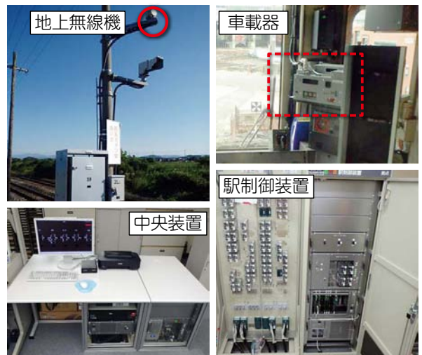
図2 境線システム各装置
